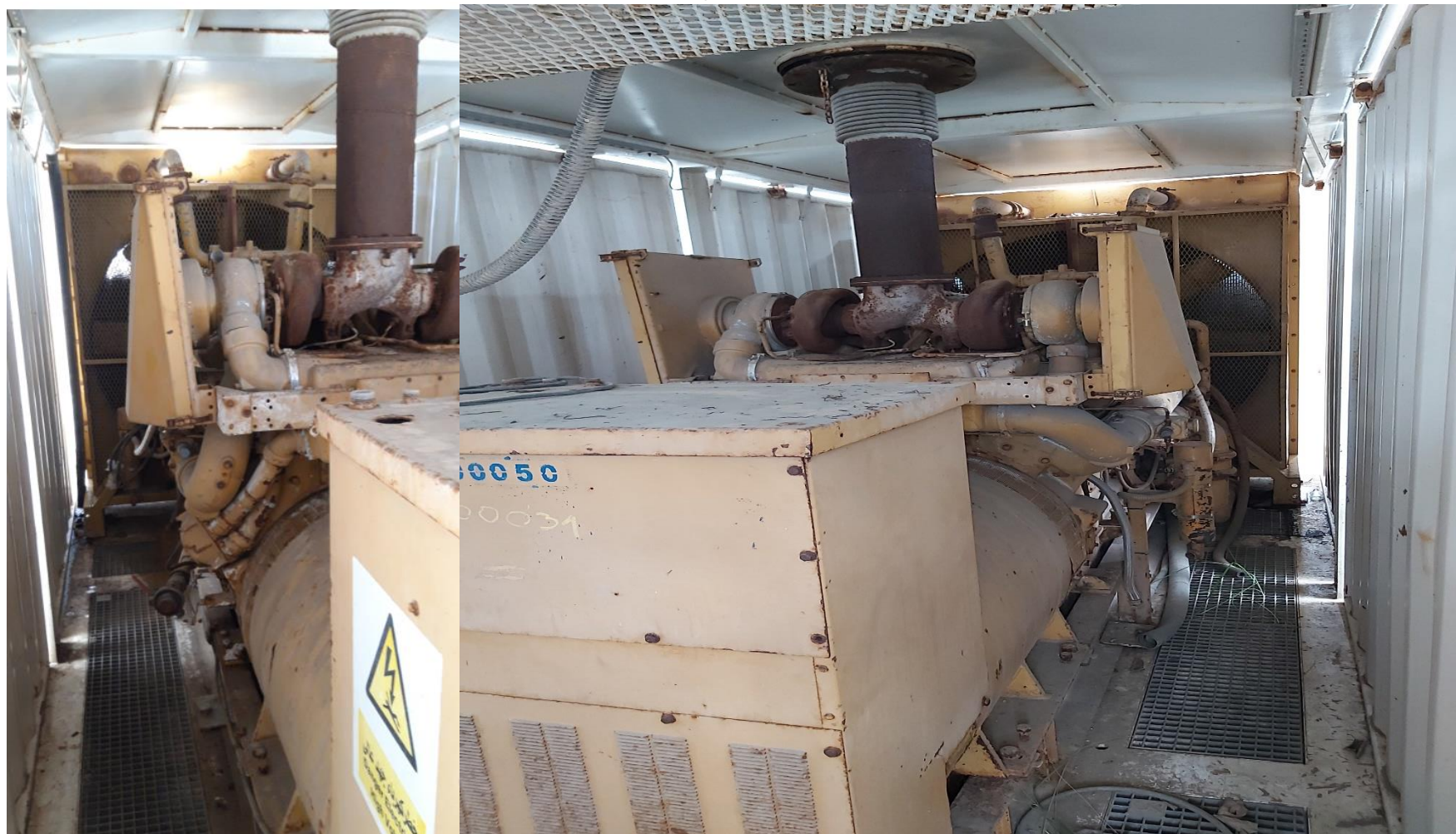
Przebieg – 50143 ; Remont kapitalny 05.05.2009 r., Przebieg – 50143 GENERATOR PRĄDOTWÓRCZY SR-4 NR INW. 3340000031 S/N AB49118 ; 1000 KVA , 60 Hz
