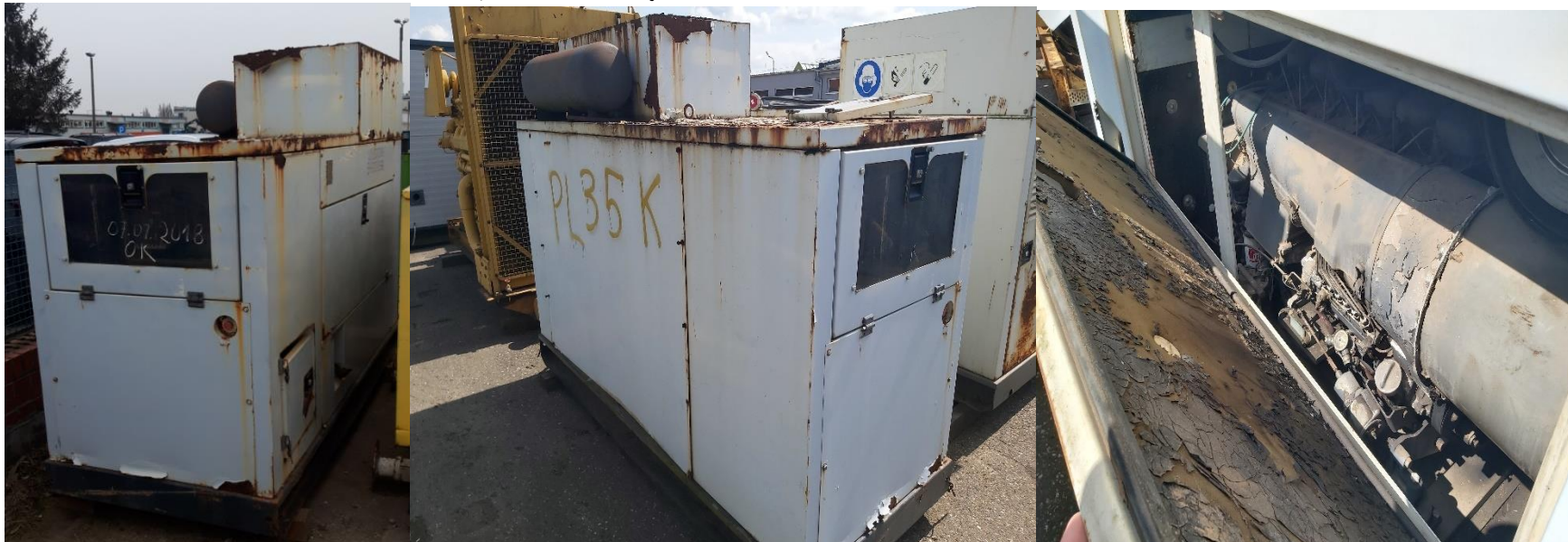
11. 3230000065 SILNIK SPALINOWY DEUTZ TYP BF6L913, 3430000056 PRĄDNICA LEROY SOMER 100 KVA
