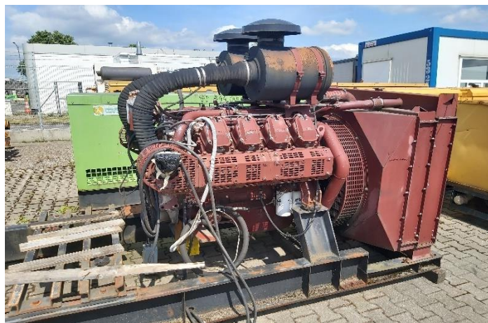
32. 344000015 AGREGAT - PRĄDNICA ECO 40-2S/4: 450 KVA, przebieg13060,
